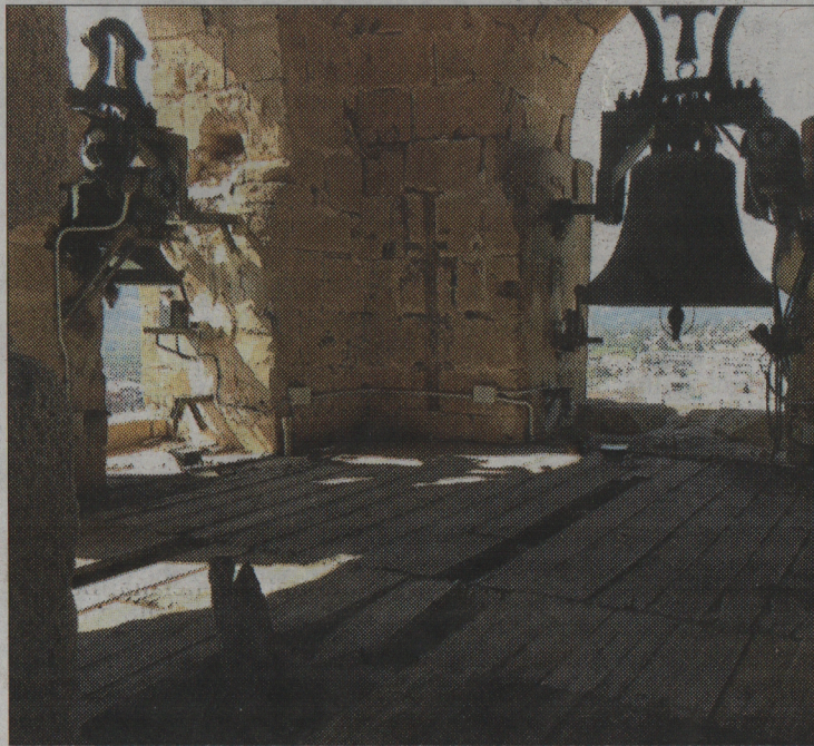
El campanario de la iglesia gótica está muy deteriorado. A. P. F.
