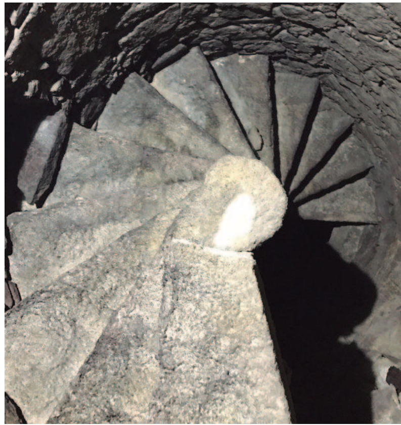
L'escala de cargol està formada per graons disposats de forma helicoidal i lleugerament encavalcats
