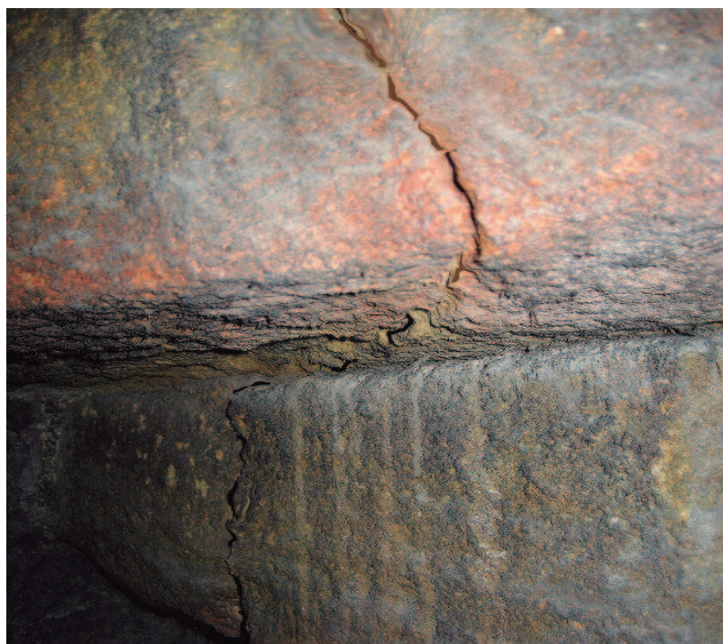
Graons de pedra esquerdat per efecte de la dilatació causada per un escalfament sobtat
