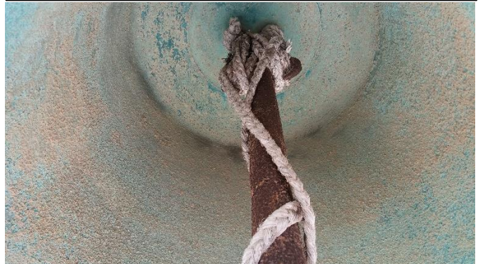
Sujeción antigua y deteriorada del badajo de la campana de las horas.
