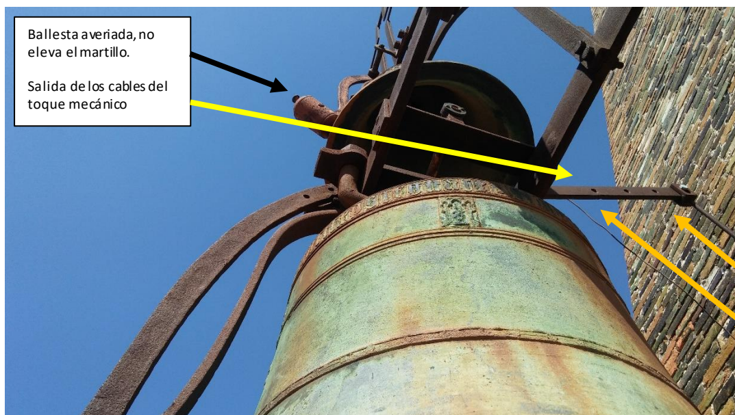
Martillo apoyado en la campana. Existe peligro de rotura de la campana si se ejecuta el toque manual.
