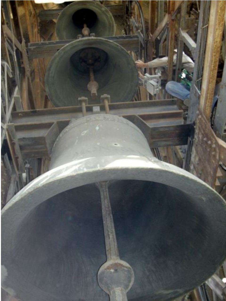
Electrificación GUIXÀ – Catedral de Barcelona (27-09-2007)
