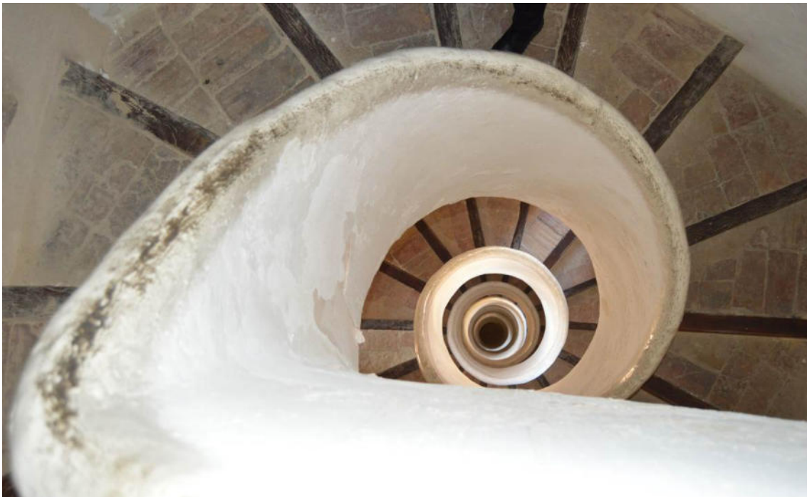
Fig. 2.A.2. Vista interior del fuste con la escalera de caracol en sentido de bajada.
