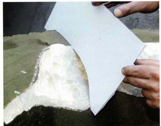
10 + 11 Tiefe der Ausschlagstellen
