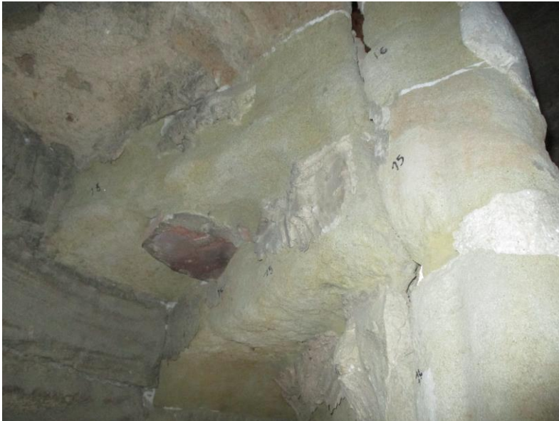
Detall de l'estat de les escales, trencades i amb reparacions de morter.
