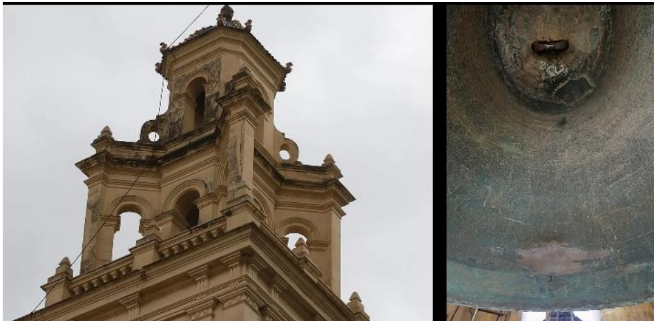
Fachada de la iglesia de El Savador y Santa Mónica, torre de Goerlich con grietas y campana que hay que refundir. Irene Marsilla
