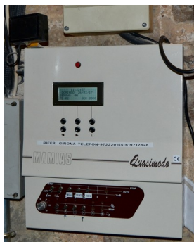
Figura 20. Quadre de control del rellotge i campanes.
