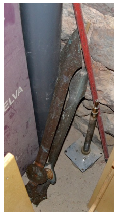
Figura 19. Joc d'agulles, i motor, instal·lats l'any 2000.
