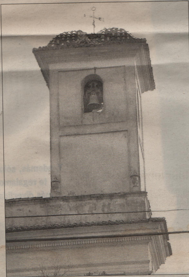
Estado en el que quedó el campanario en Utiel.
