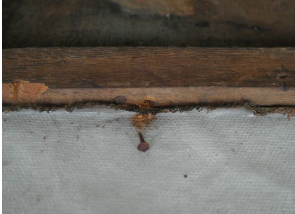
Fig. 19 - Detalle de los clavos oxidados extraídos en el desmontaje del bastidor
