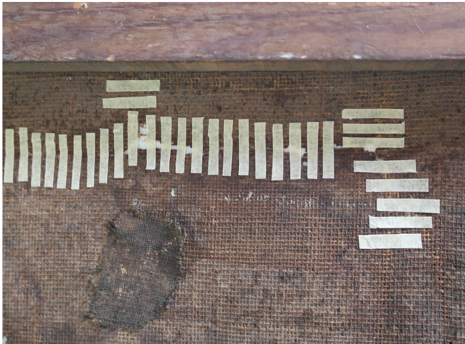
Fig. 11 - Detalle de la unión provisional de rotos y desgarros
